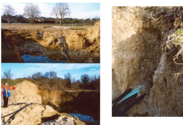
Figure 1 : brèches sur les digues de la Mosson (34), vraisemblablement initiées par la présence de câbles en tranchée traversant la digues
