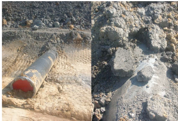
Figure 2 : canalisation traversante à la base d'une digue, sans traitement spécifique
