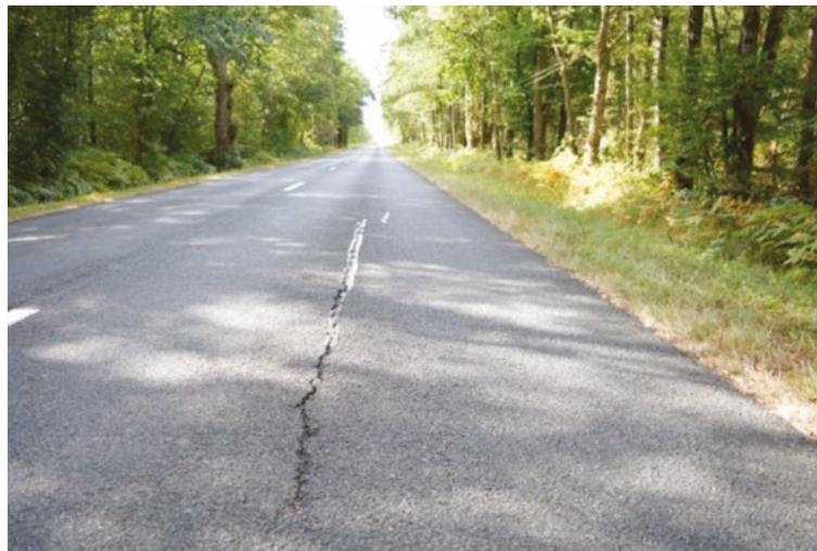
Photographie 1: Exemple de phénomène de retrait avec apparition d'une fissure longitudinale (Source : Observatoire des Routes Sinistrées par la Sécheresse pour optimiser les réparations (ORSS))
