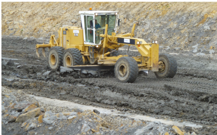
Photographie 20: Cas typique d'une PST0 impropre à la circulation de chantier et à la mise en œuvre d'une couche de forme (Source : SCSNE)
